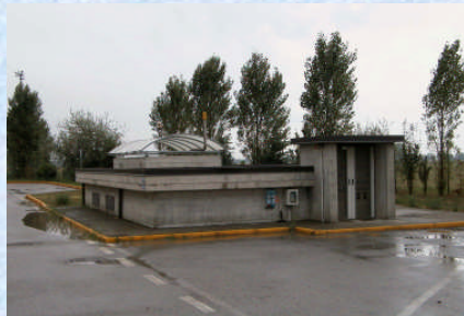
“Stazione rilancio percolato”
