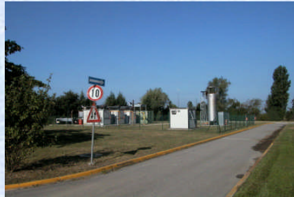
“Impianto di aspirazione, combustione e gruppi di produzione energia elettrica”
