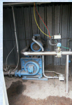
Impianto di aspirazione
